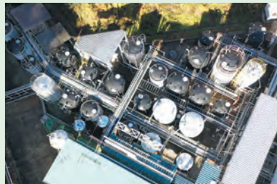
屋外配合タンク(第1工場)
