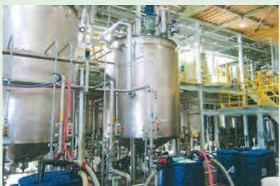
屋内配合タンク(第2工場)
