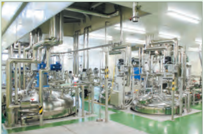
屋内配合タンク(化粧品工場)
